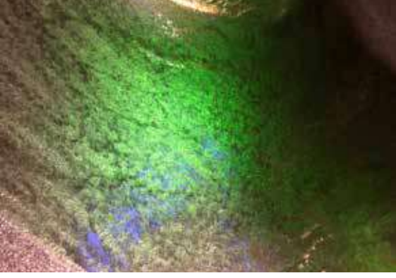
Şekil 11b: Konik ara tüp ile aynı yüzey çatlaması
